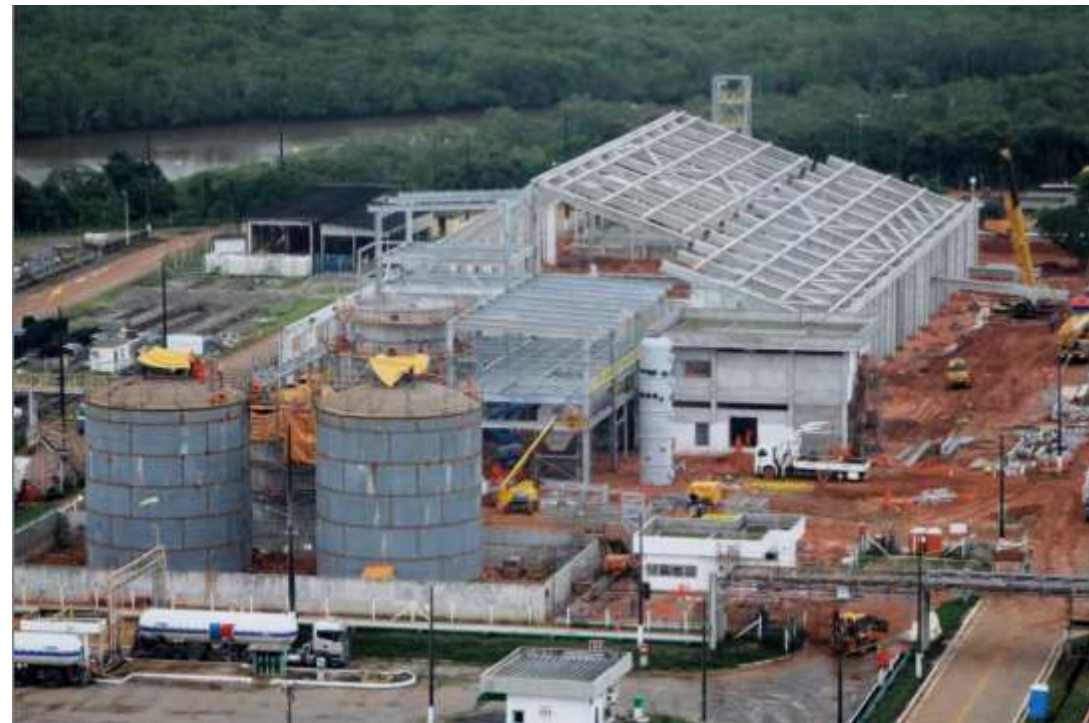
Vista Panorâmica da Unidade de Sulfato de amônio (17 de Julho de 2013)
